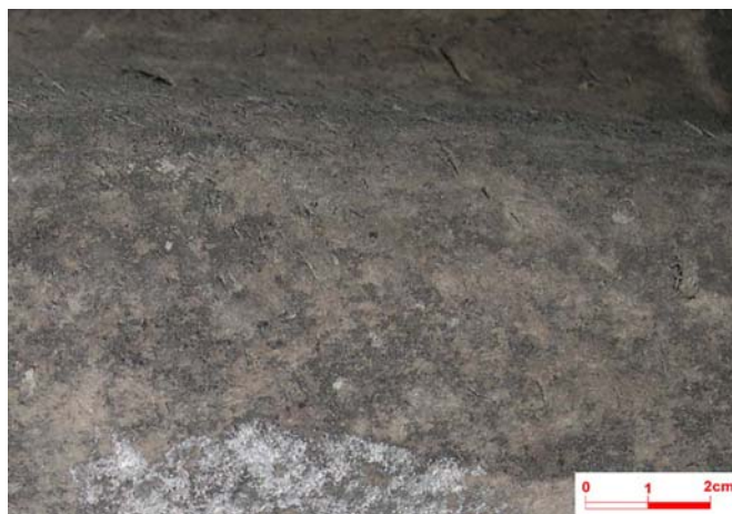
Foto 12 – Detalhe da Telha Am-3 (LPTR 323/05), observando-se fibras se despreendendo da superfície da telha.
