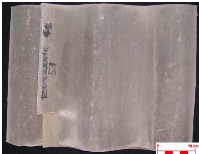
Foto 16 – Telha Am-5.1 (LPTR 325/05), amostrada na Fábrica de Eixos.
