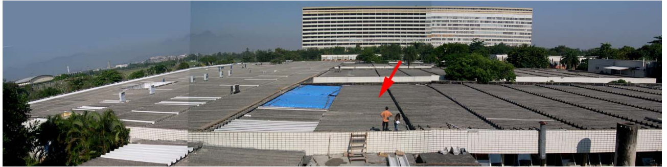
Foto 34 – Aspecto geral do telhado do Centro de Ciências da Saúde, na Ilha do Fundão. A seta indica telha selecionada para amostragem
