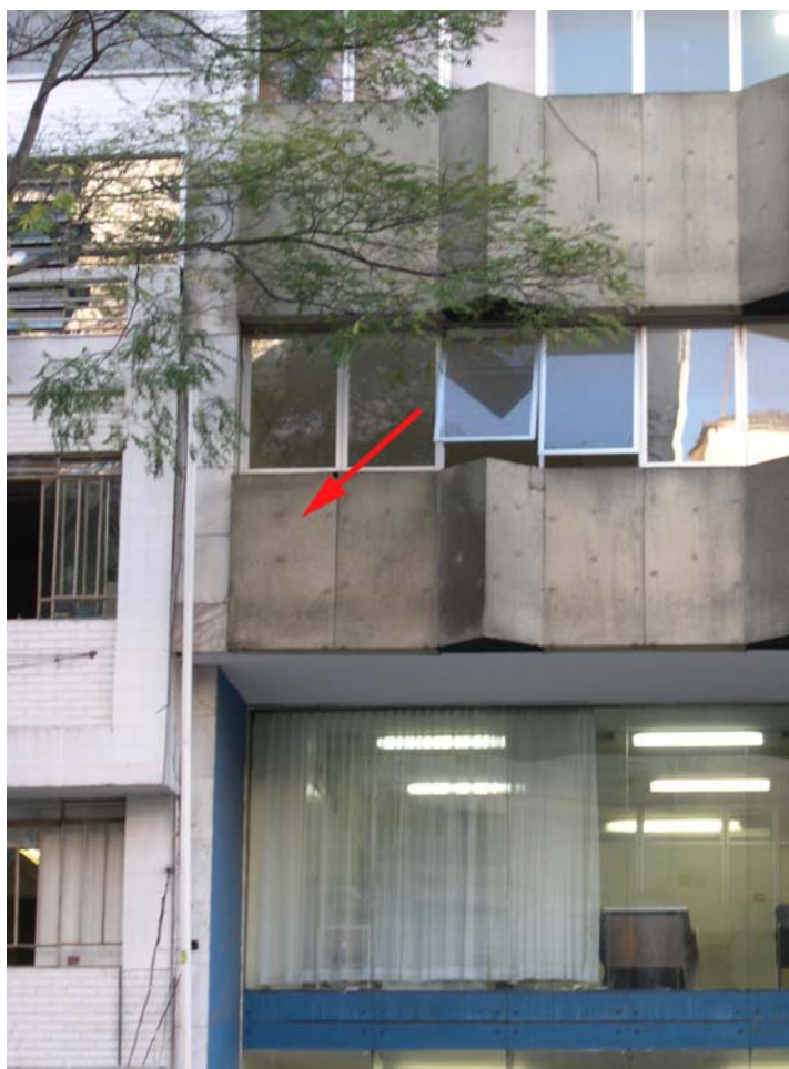
Foto 76 – Detalhe da FOTO anterior, com a seta indicando a placa cimentícia amostrada.
