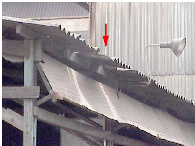
Foto 8 – Detalhe da FOTO 7 com indicação do local de coleta de telha.
